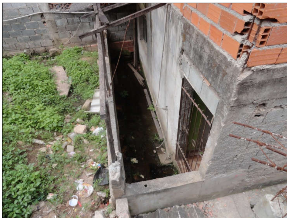
Foto FC-ITA-15-01.04: Vista de detalhe de muro de contenção no setor e concentração de água de chuva e servida no quintal de moradia.
