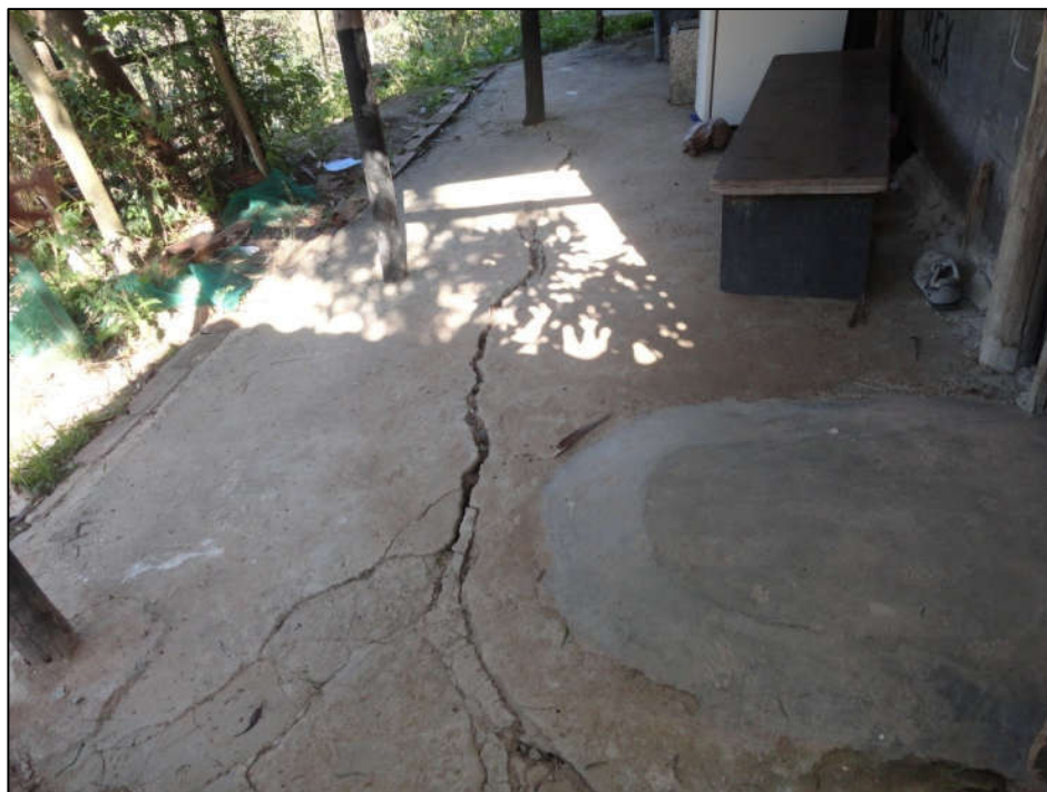
Foto FC-ITA-14-02.04: Trinca no terreno evidenciando a movimentação dos aterros no setor.
