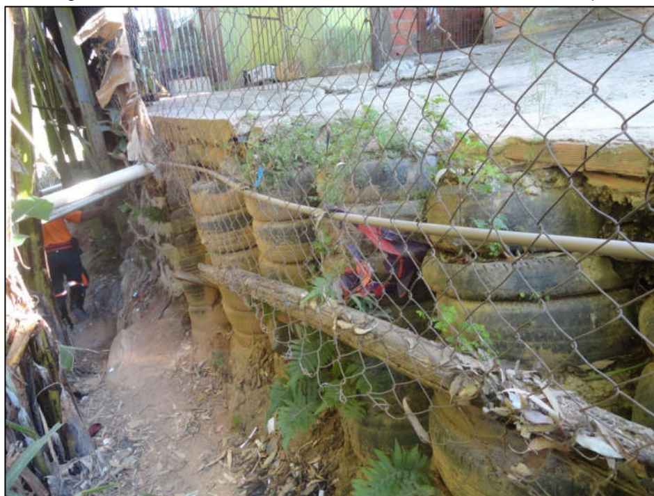
Foto FC-ITA-14-02.02: Vista de contenção com pneus.
