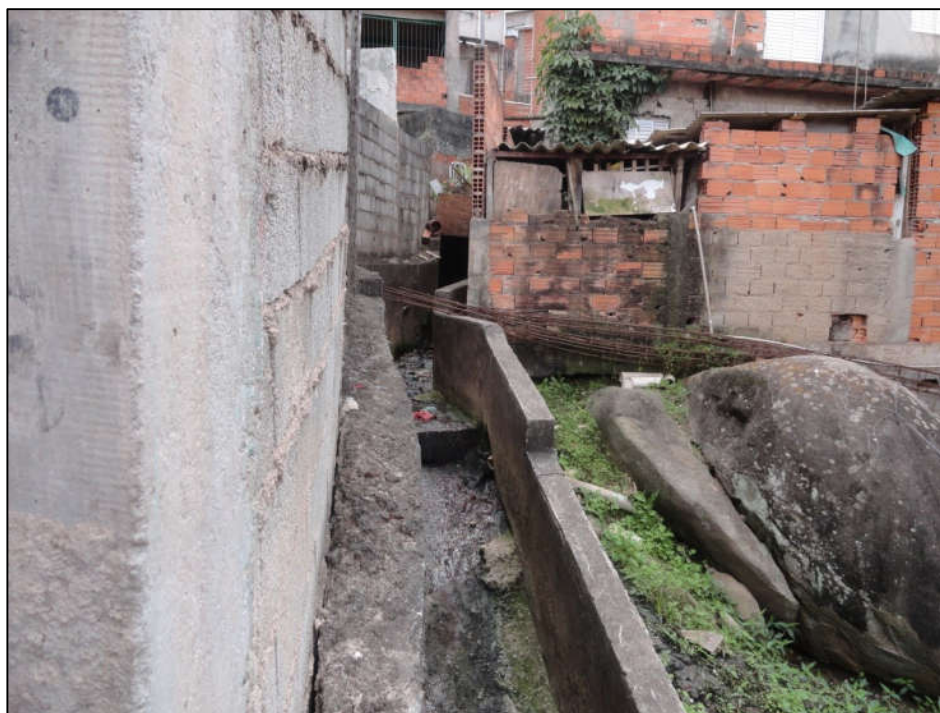
Foto FC-ITA-15-01.02: Bloco de rocha (matacão) e drenagem de águas servidas em meio ao setor..
