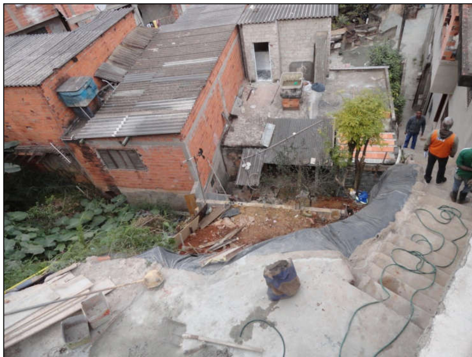
Foto FC-ITA-15-03.02: Moradia ameaçada vista a partir do topo do talude de corte, podendo-se observar parte da obra de contenção.
