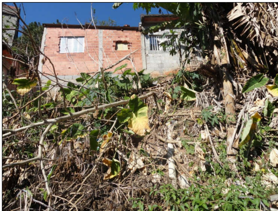
Foto FC-ITA-13-02.03: Aspecto da ocupação no topo do talude de corte e vegetação.
